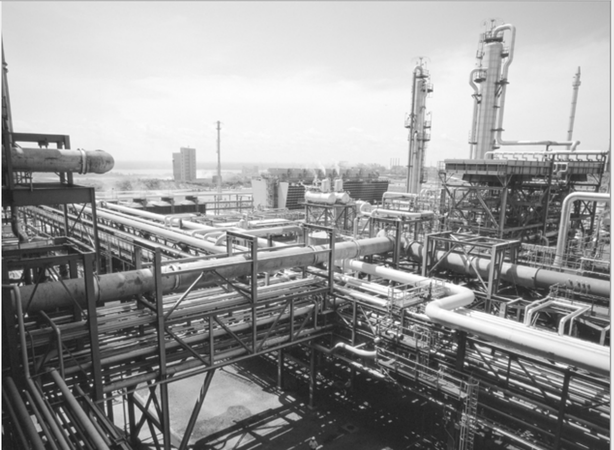
Reformador de gases de la planta Orinoco Iron
